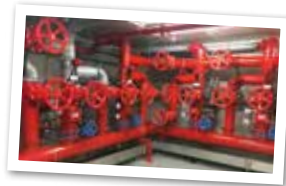
Technik in der Elbphilharmonie
