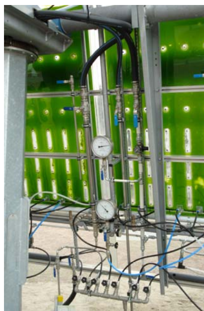
Hier wird Energie erzeugt: Detail der Mikroalgen-Anlage.
