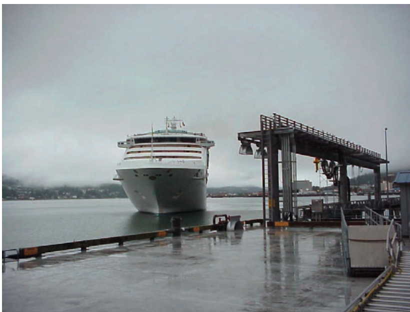
Bild 17 - Anschluss mittels Kabelbrücke im Hafen von Juneau
